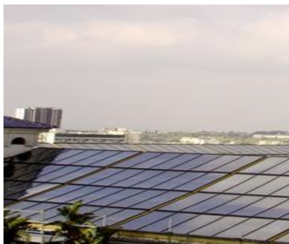
Figura 1.4 - Painéis solares na cobertura do edifício sede da CGD [W.1]
