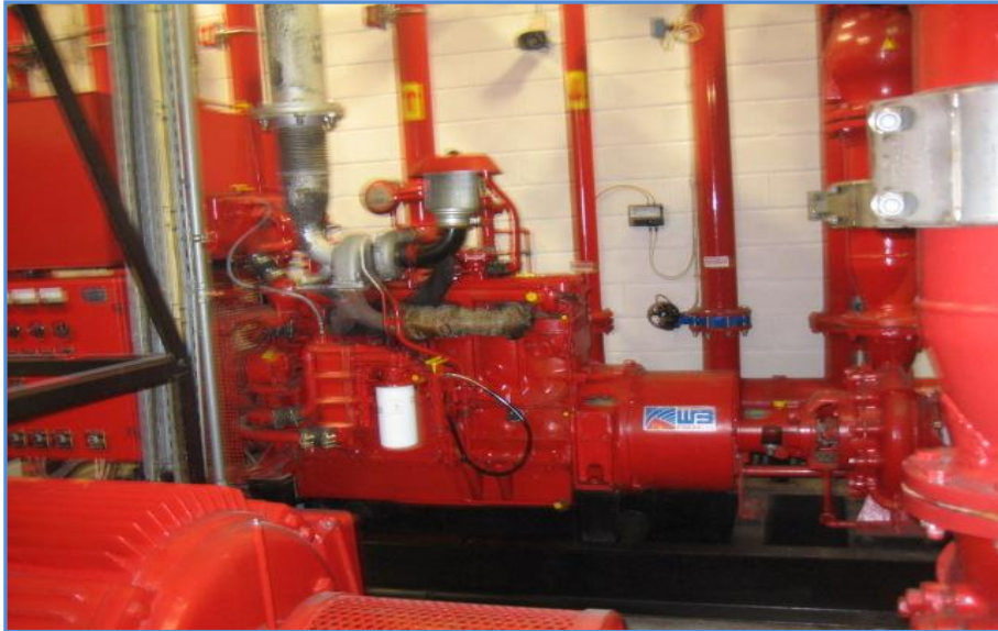
Figura 3.4 - Central de bombagem da rede de incêndio –[ Fonte: a autora]
